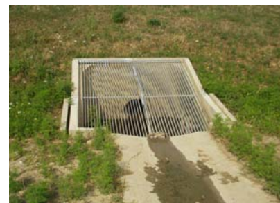
Grille de protection sur ouvrage de sortie
