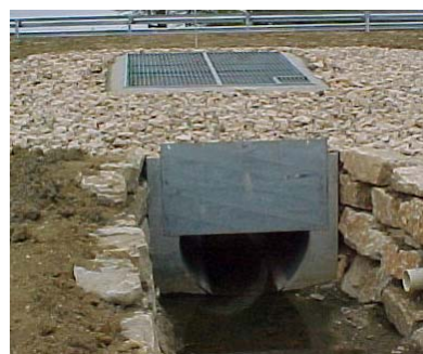
Plaque métallique fixée sur orifice de sortie
